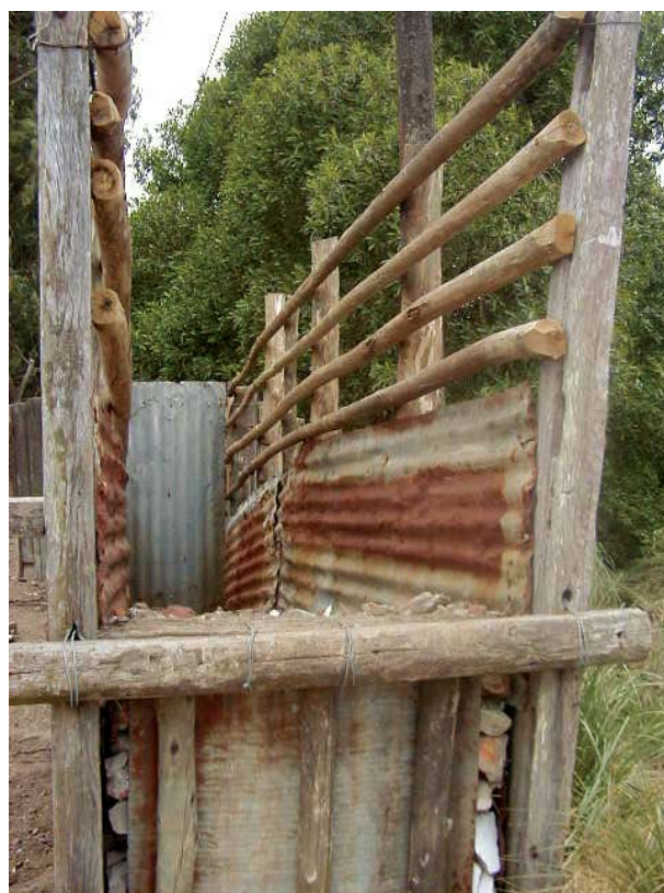
Fig. 12. Embarcadero con características constructivas inadecuadas. (Foto: INAC).
